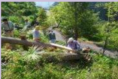
景観の支障になっている木も自分たちで伐採。伐採した木は、近くの製材所に持ち込み、建材として利用する。
